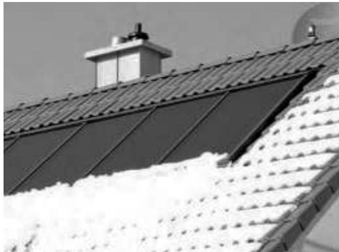
Alarmfall: Bedeckt Schnee die Photovoltaikmodule, führt das zu Ertragsausfällen.
