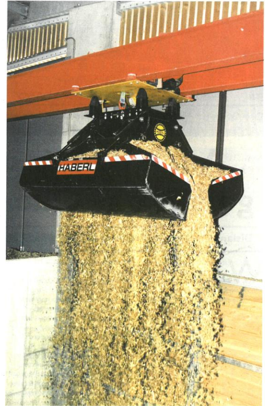
Im Inneren der Holzhackschnitzel-Anlage in Müllheim.
